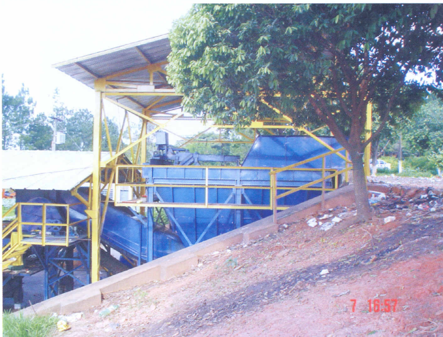
Foto 5: Detalhe lateral da moega de recebimento do lixo cru.
