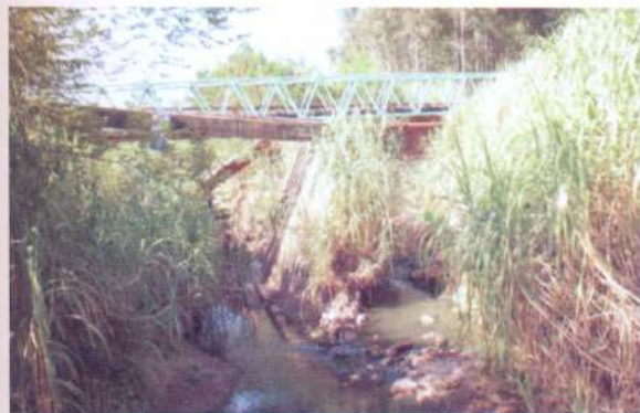
Figura 9: O córrego Tocantins, margem direita, sentido Adamantina – Bairro Alto da Boa Vista.
