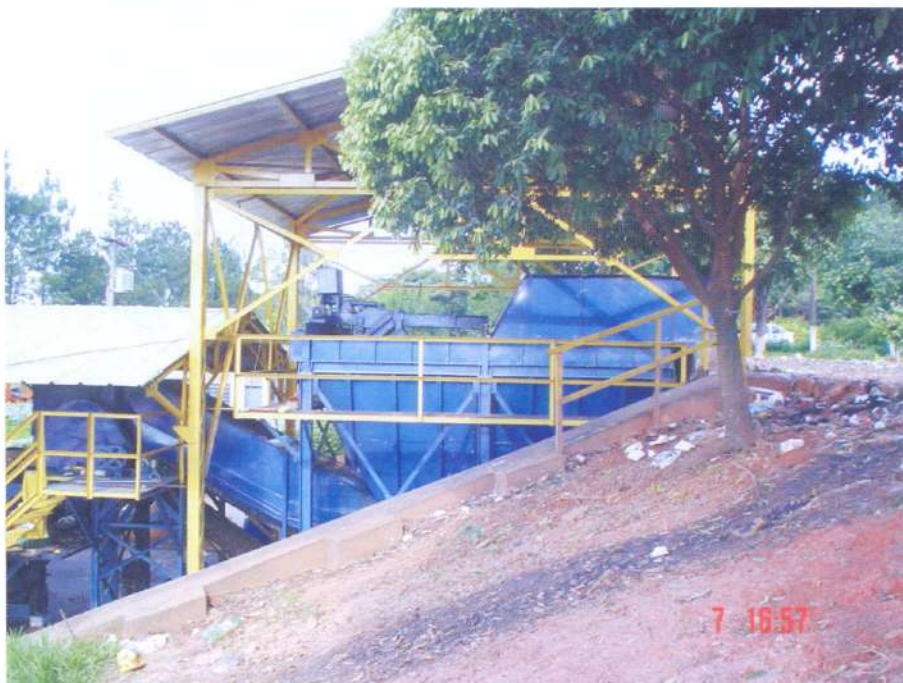
Foto 5: Detalhe lateral da moega de recebimento do lixo cru.
