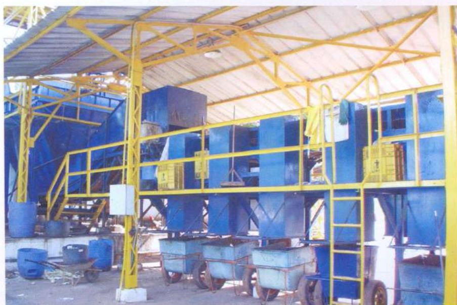
Foto 6: Esteira de triagem, com os carrinhos de recepção dos materiais separados.
