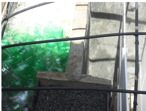
Figura 9: Sistema de filtro de pedra brita e polímeros diversos. Completando o sistema de tratamento foi instalado um filtro biológico de carvão ativado granular em uma conexão de três entradas adaptadas com uma tela de contenção de material suporte.
