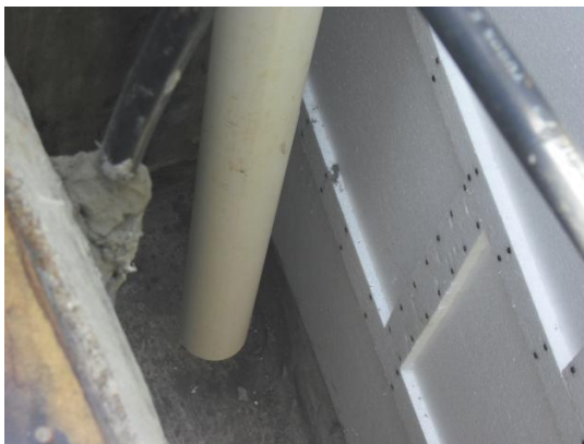
Figura 4: Sistema de entrada do efluente no biorreator.
